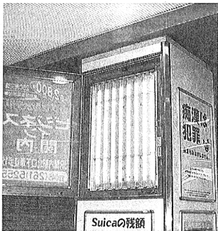
駅構内の柱の看板に付けられている冷陰極管を使った照明「モノキョウト」
